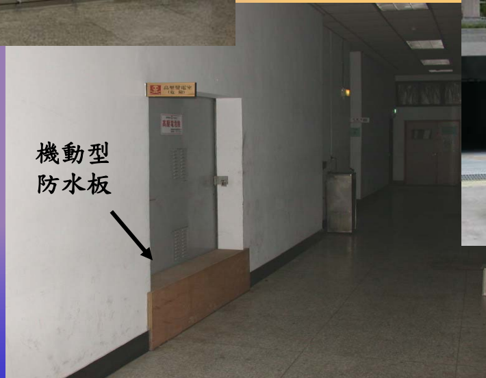
教研大樓 高壓機房
